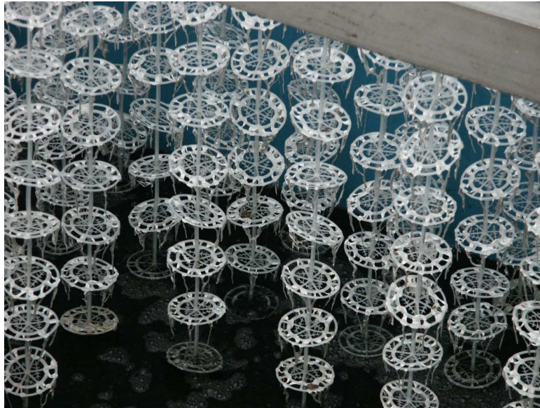
Figure 8 : Installation d'un réacteur biologique avec des " Pompons chinois "
